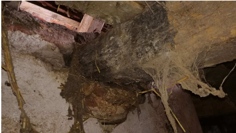
7. sz. kép : a födémgerenda vége teljesen elkorhadt
