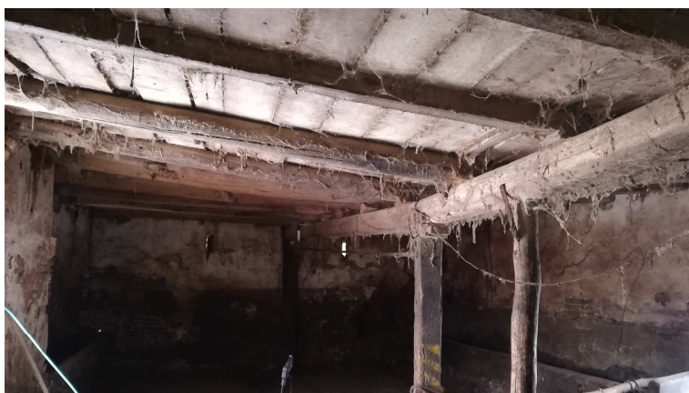
6. sz. kép : az istálló födémgerendái a megengedettnél jóval nagyobb mértékben lehajoltak
