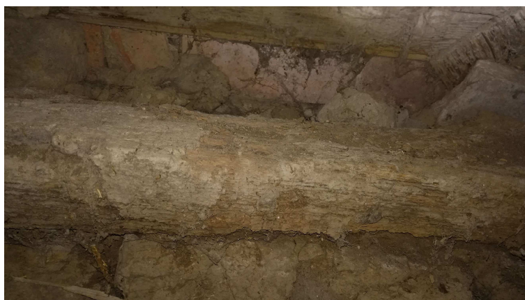
4. sz. kép : a sárgerenda teljesen elkorhadt
