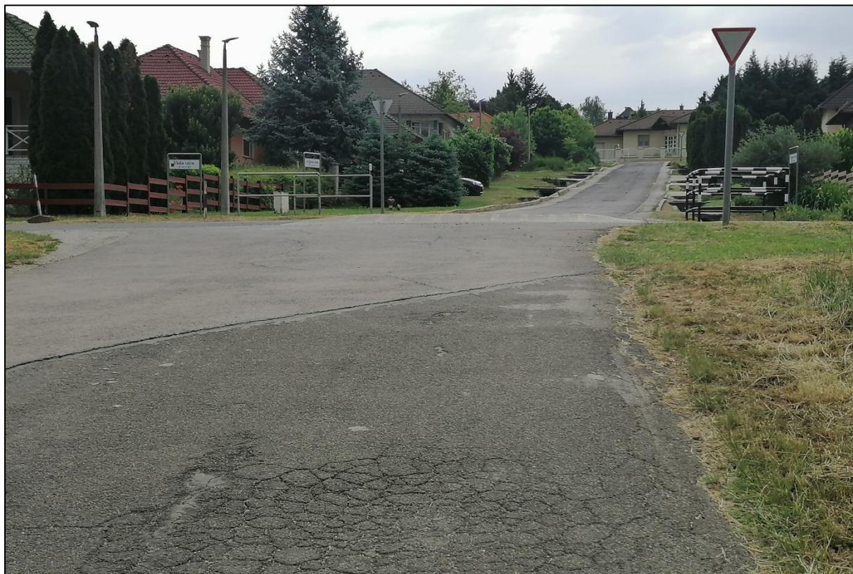
9. sz. fénykép: A Kamilla utca és a Viola utca csatlakozásában lévő, nem megfelelően észlelhető burkolatmagasítás
